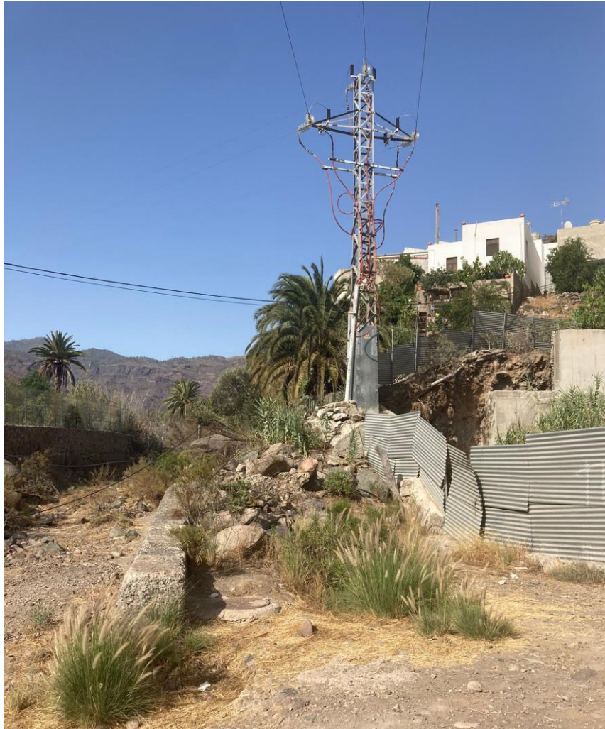
Torre de alta tensión en el ámbito de estudio. Fuente: Ayuntamiento de Mogán
