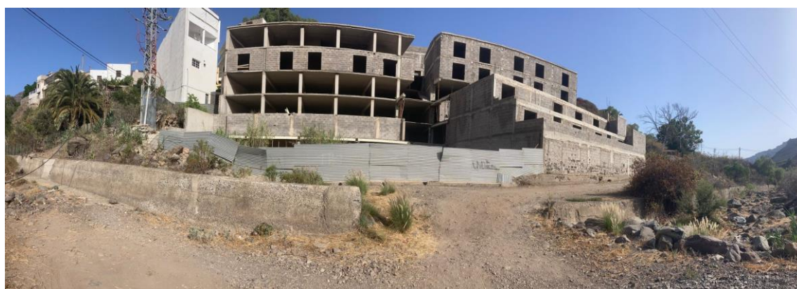
Edificación sin finalizar situada en las cercanías del Barranco de Mogán. Fuente: Ayuntamiento de Mogán.
