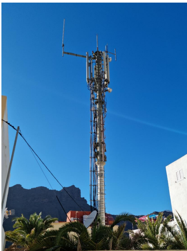
Antena de telefonía móvil vista desde calle El Mocán. Fuente: LPA Studio.
